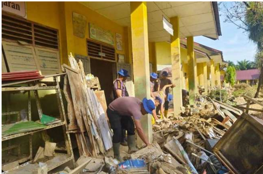
Gambar 5 Pembersihan material banjir di sekolah terdampak di Aceh Tamiang, Januari 2026
